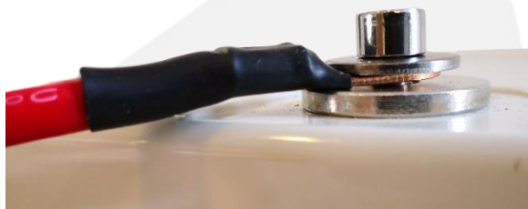
Figure 3. FAUX! Connexion desserrée en raison de l'utilisation d'un boulon trop long
